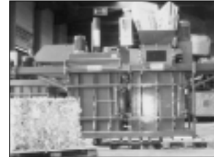
Aufgebauter Zerkleinerer/ Shredder/ Restmüllzerkleinerung
